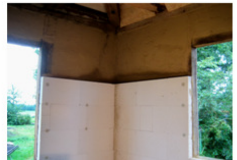
Pasststücke der Ytong Multipor Minerale Dämmplatte werden mit einem Fuchsschwanz leicht auf die beliebigen Maße zugeschnitten, so dass alles passt, auch an schwierigen Stellen.
