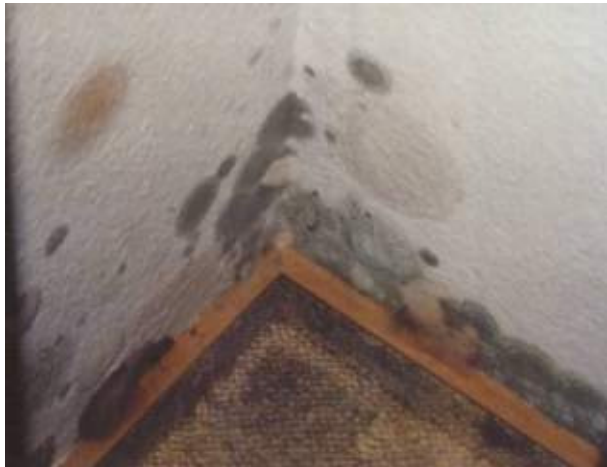
Abb. 3: Schimmelpilz an Innenecke
